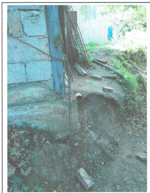
CAPOSALDO "2" CHIDO MINIATO SU FONDAZIONE CAPANNONE, LATO OVEST
